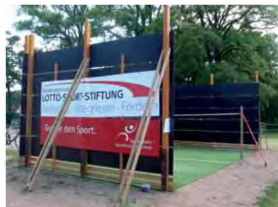
Die neue FuWaTe-Anlage bei der SG74
